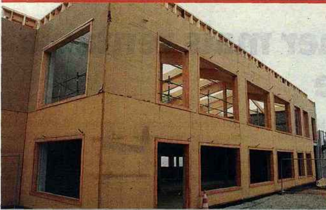
▲ Le bâtiment (27 m x 16 m) comporte une structure mixte béton-bois sur laquelle sont assemblés 31 panneaux hauteur plancher-plafond intégrant les précadres en mêlée des huisseries et les gaines techniques.
